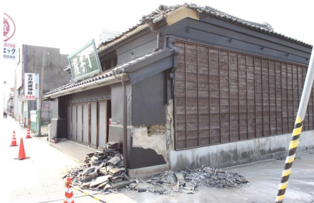
อาคารที่ได้รับความเสียหาย จากภัยพิบัติแผ่นดินไหวครั้งใหญ่ทางตะวันออกเฉียงใต้ของญี่ปุ่น(ชิงากิ นิงง ไตชินไซ)
