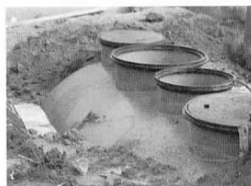
▲合併処理浄化槽
