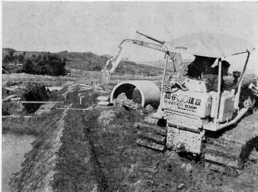
支線排水路の一部には、直径1.5mのヒューム管が埋められる
