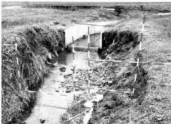
水路の護岸崩壊。大増地内
