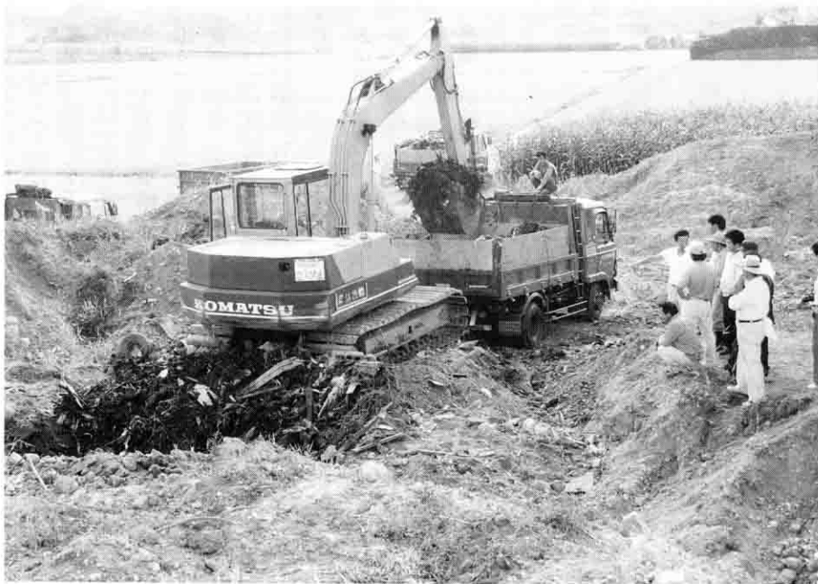
不法投棄から45日目で完全撤去され解決（瓦谷地区）
