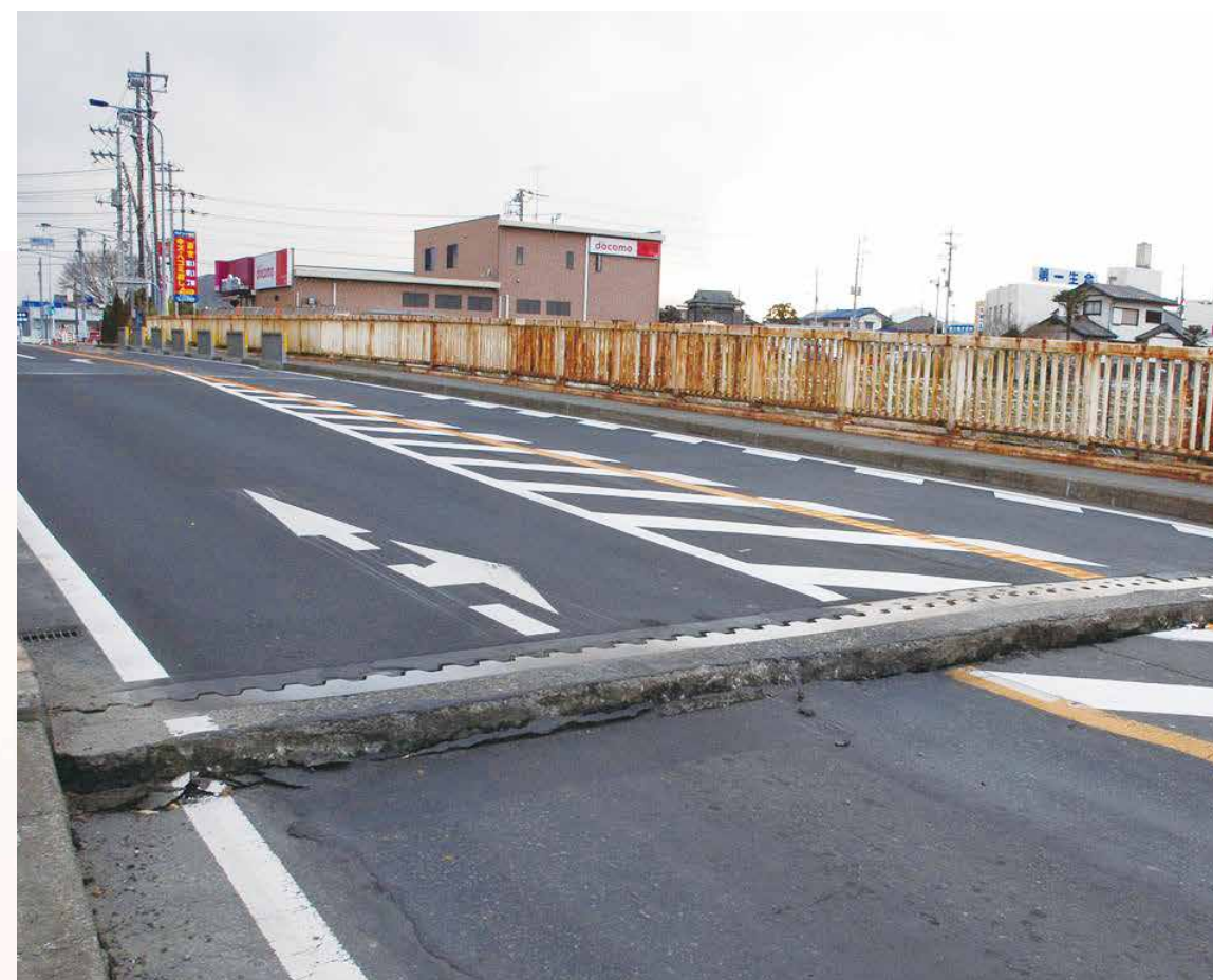
跨線橋に大きな段差ができ、国道6号が通行止めになった
