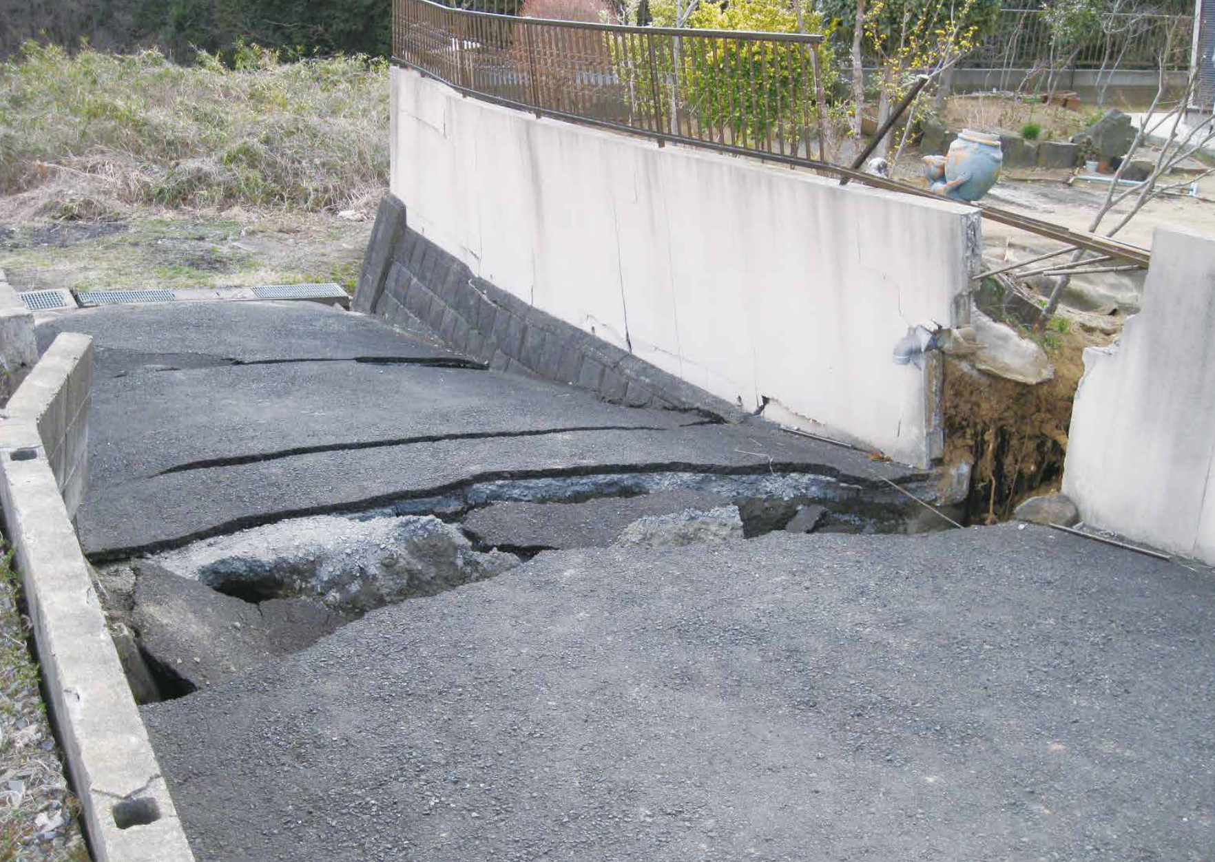
地面が割れ、ゆがんだ道路（鹿の子地内）
