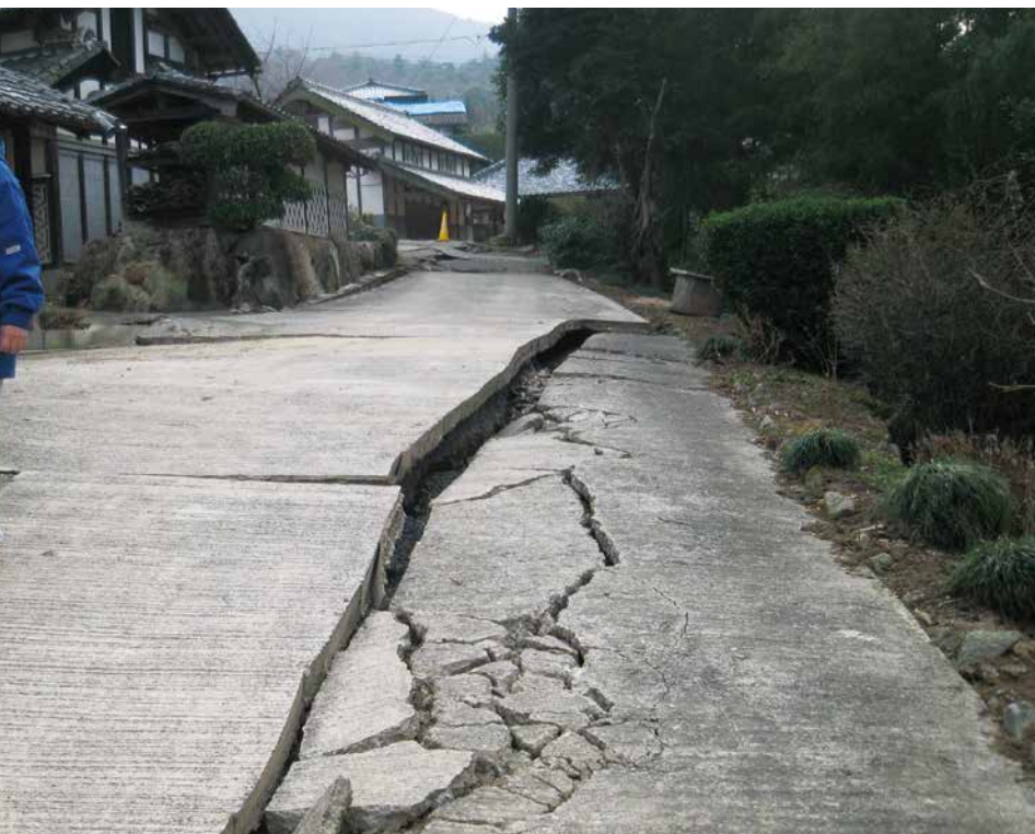
コンクリート道路が断裂した(中戸地内)
