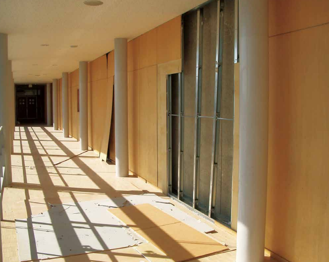
校舎の壁が剥がれ落ちた（府中中学校）
