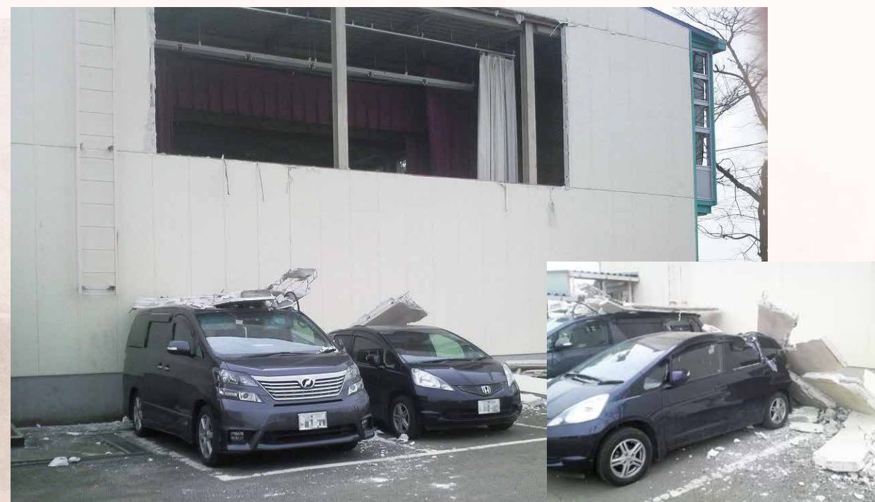
体育館の壁が崩落。駐車していた車を直撃した（北小学校）
