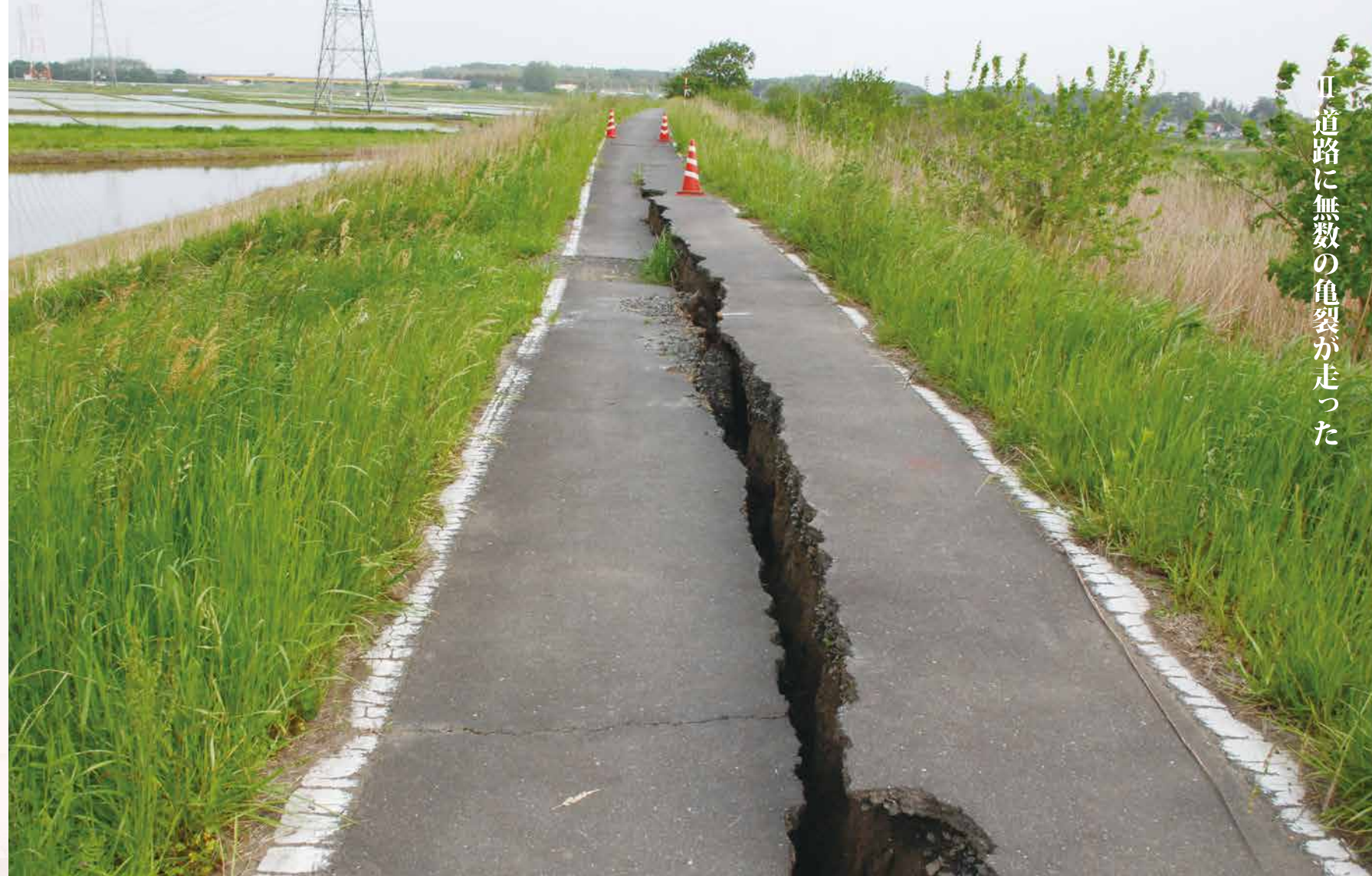
サイクリングロードにも地割れ(染谷地内)
