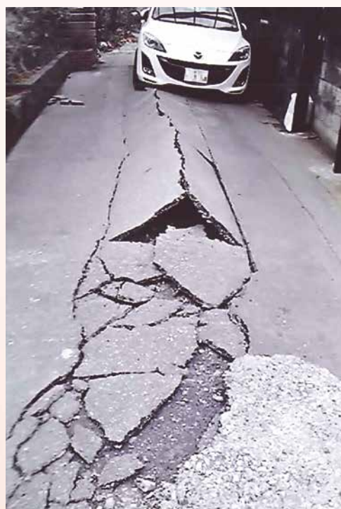
アスファルトが隆起した(総社地内)
