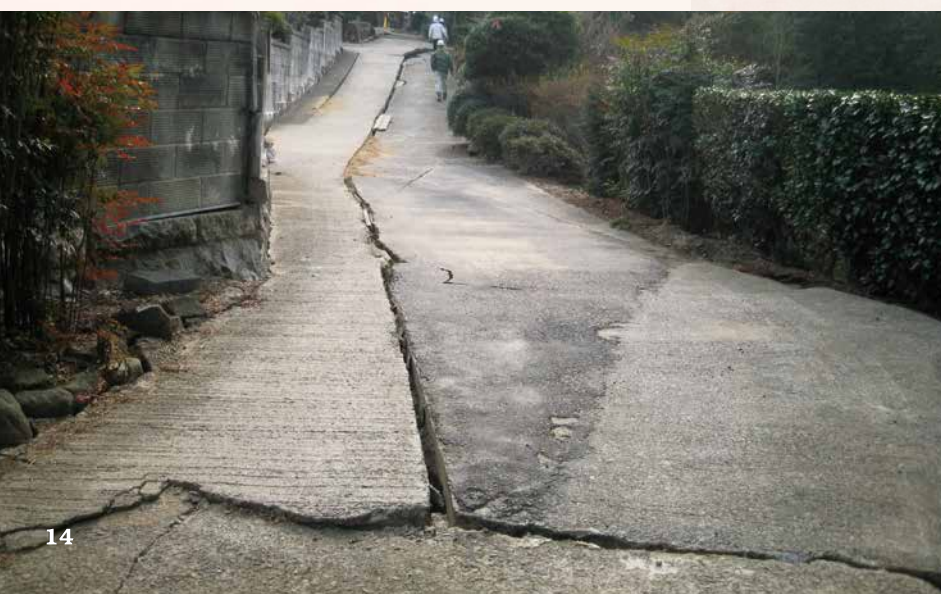
ひび割れたコンクリート道路（中戸地内）
