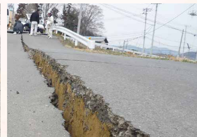
地中の土が露出した（恋瀬橋付近）
