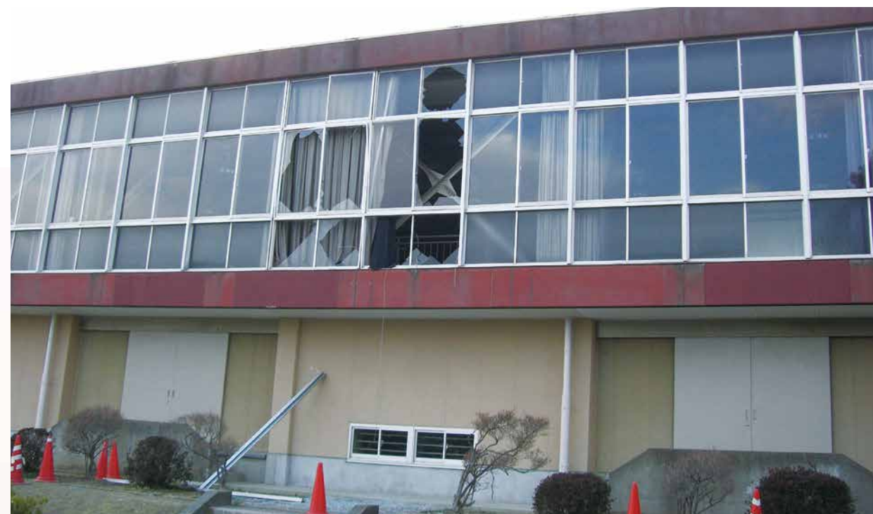
体育館の窓ガラスが割れ落ちた（南小学校）
