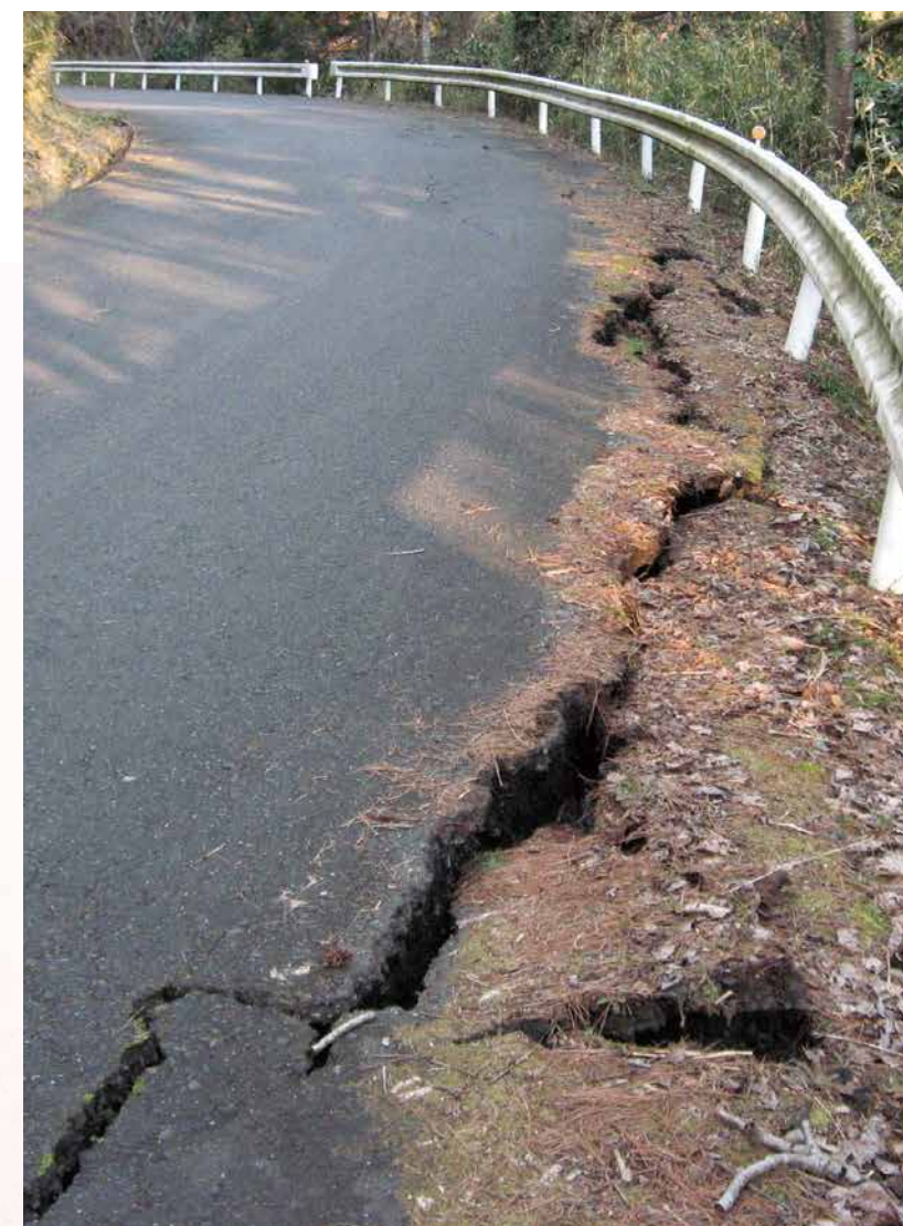
峠道に地割れができる（上曽地内）
