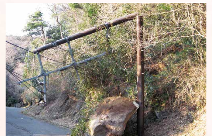
落石で折れた電柱(西光院付近)
