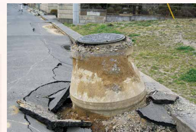
液状化によりマンホールが隆起した（石岡一高付近）
