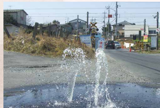
マンホールから水があふれ出す（泉町地内）
