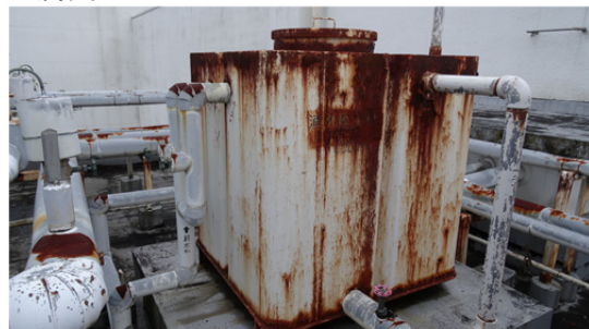
中央公民館 消火水槽
