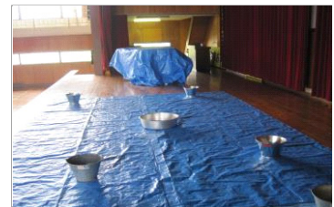
部位名称 体育館・ステージ ステージ上部からの雨漏りのため、常時ブルーシートを敷き詰め、雨漏り箇所にバケツやタライを置いている。
