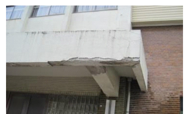
部位名称 体育館・正面玄関屋根部分 コンクリートが劣化し、表面がはがれている。
