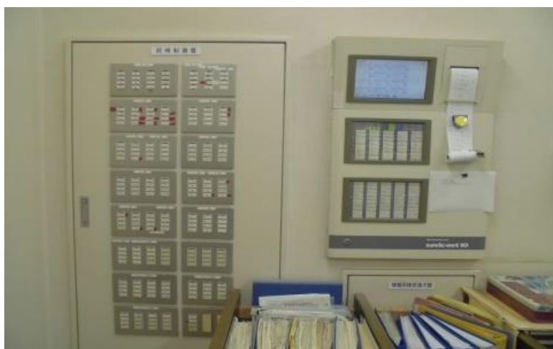
空調設備の中央監視盤
