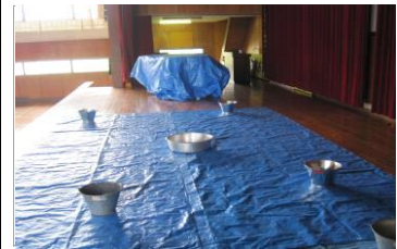
部位名称 体育館・ステージ ステージ上部からの雨漏りのため、常時ブルーシートを敷き詰め、雨漏り箇所にバケツやタイヤを置いている。
