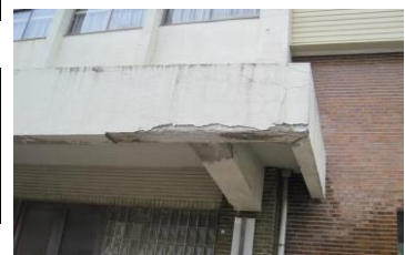
部位名称 体育館・正面玄関屋根部分 コンクリートが劣化し、表面がはがれている。
