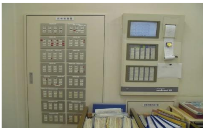
空調設備の中央監視盤
