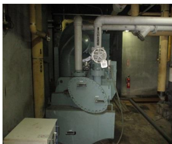
ターボ冷凍機 日立 昭和42年製造
