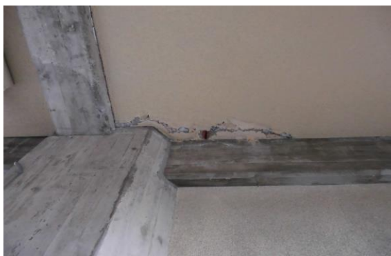
〔1階ホワイエ〕天井部分にクラック・鉄筋が露出・発錆
