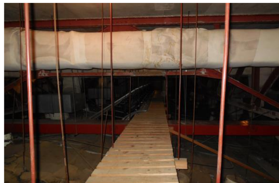
〔3階ホール裏側〕吊りボルト揺れ止めなし
