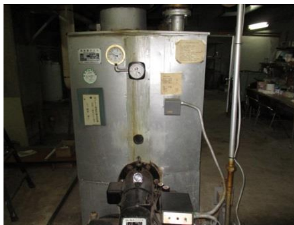
ボイラー 川崎重工 昭和53年製造
