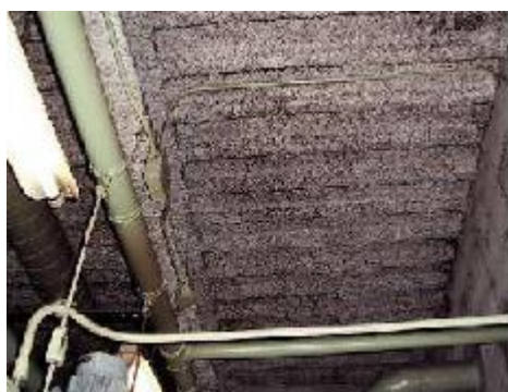
石綿含有吹付けロックウール
