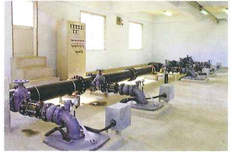
▶ 配水ポンプ室
