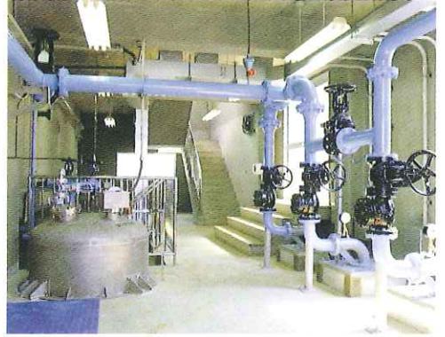
▶ 洗浄ポンプ室
