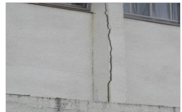
部位名称 体育館・正面玄関上部 大きくクラックが入っている。
