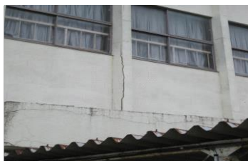
部位名称 体育館・正面玄関上部 大きくクラックが入っていて、表面がはがれ落ちそうである。
