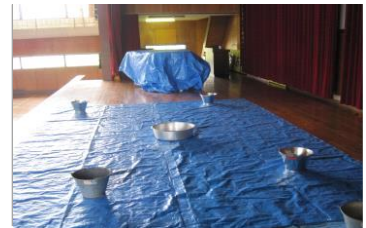
部位名称 体育館・ステージ ステージ上部からの雨漏りのため、常時ブルーシートを敷き詰め、雨漏り箇所にはケツやタライを置いている。
