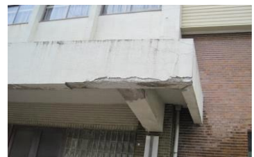
部位名称 体育館・正面玄関屋根部分 コンクリートが劣化し、表面がはがれている。
