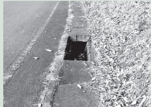
▲市内における側溝の蓋（グレーチング）の盗難現場
