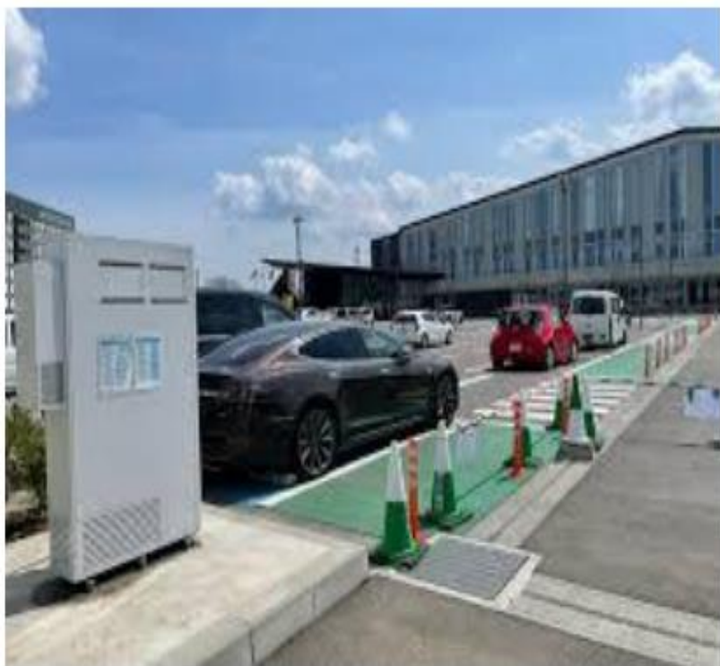
本庁舎に設置してある EV 充電施設
