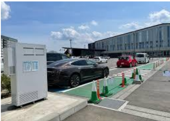
本庁舎に設置してあるEV充電施設
