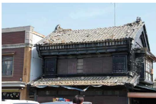
福島屋砂糖店店舗兼住宅被害状況
