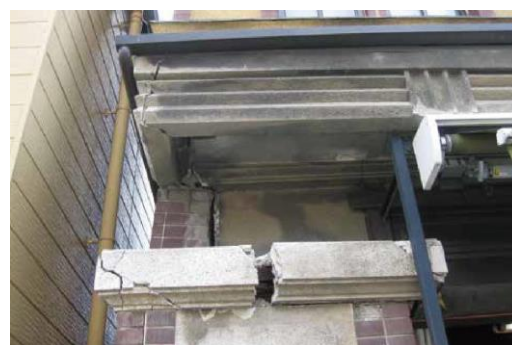
十七屋履物店店舗兼住宅被害状況
