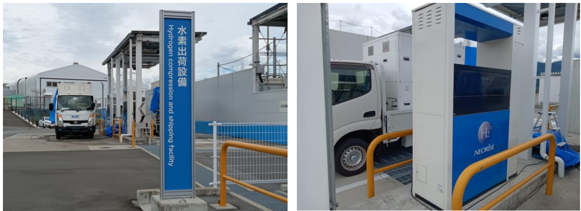
燃料水素出荷設備の様子
