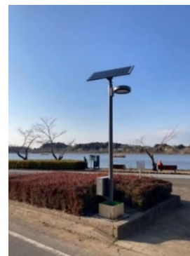
ソーラー街路灯の設置例
