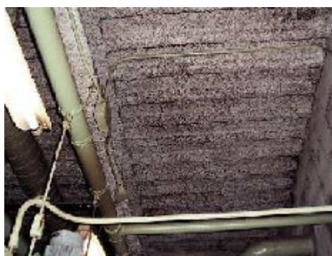
石綿含有吹付けロックウール
