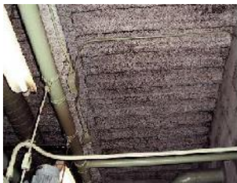
石綿含有吹付けロックウール
